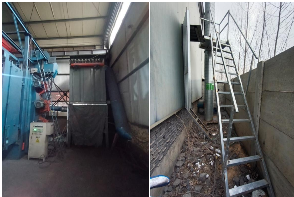
抛丸废气处理设施及排气筒
