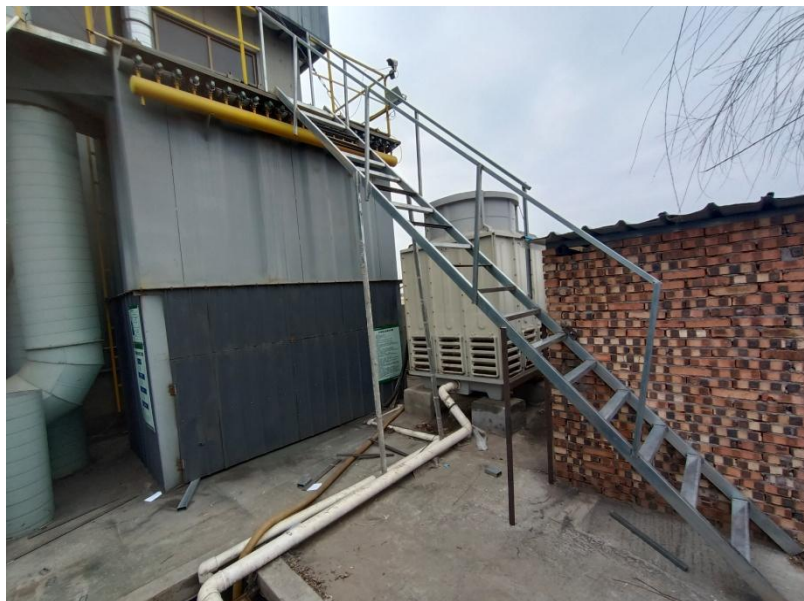
废气处理设施及排气筒
