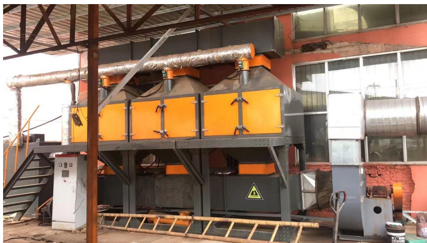
水旋除尘+干式过滤+活性炭吸附+催化燃烧装置
